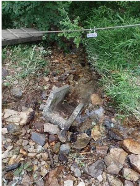
被災した水路分岐部 （2023年6月5日）
