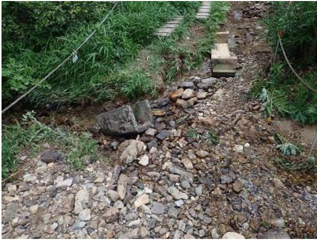
被災した水路分岐部 （2023年6月5日）
