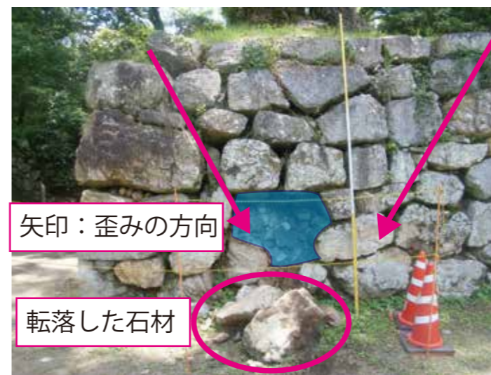
・崩落直後の状況。石垣中央下部の2石が転落した。青塗り部分が、転落した石材本来の位置。右写真の大木の過重で、石垣全体に逆三角形の歪みが生じ、その最下部の石材が転落したことが分かる。崩落した石材の大きさは、長さ0.8m×幅0.4m×厚さ0.45m程度。
