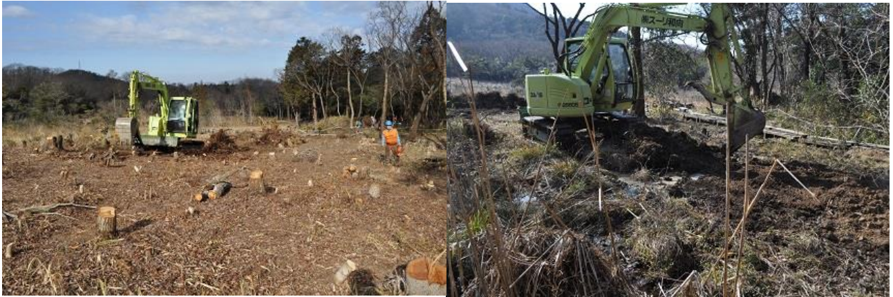
P地点抜根作業（南から：2019年2月5日） F地点旧水田部分の抜根作業（東から）
