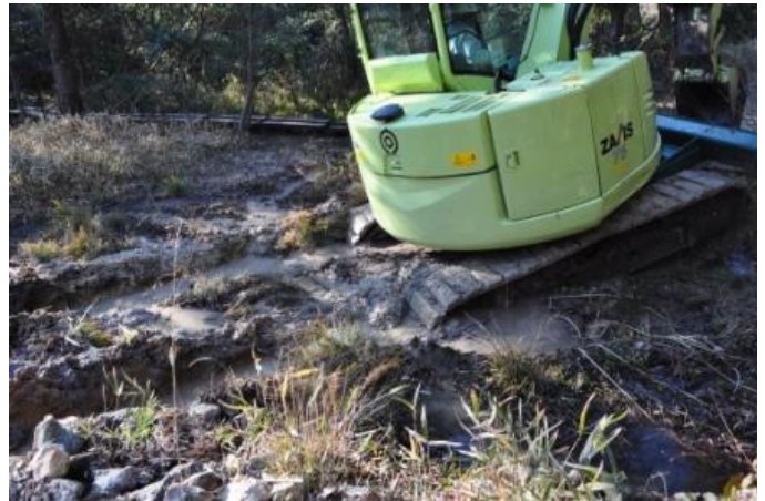
F地点の旧水田内を進むバックホー キヤタピラ部分が沈んで深い溝になっている
