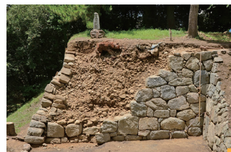
⑫中段・南半部の発掘調査完了 【埋め殺し】石垣が姿を現しました。大型土嚢で隠れていた石垣下部で変状が見つかり、解体範囲が増えました。
