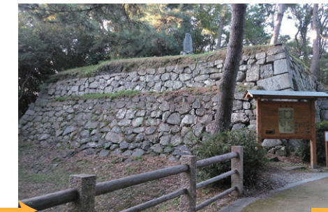
⑥崩落前の千貫櫓台（令和元年11月） 看板は崩落に巻き込まれ、壊れてしまいました。
