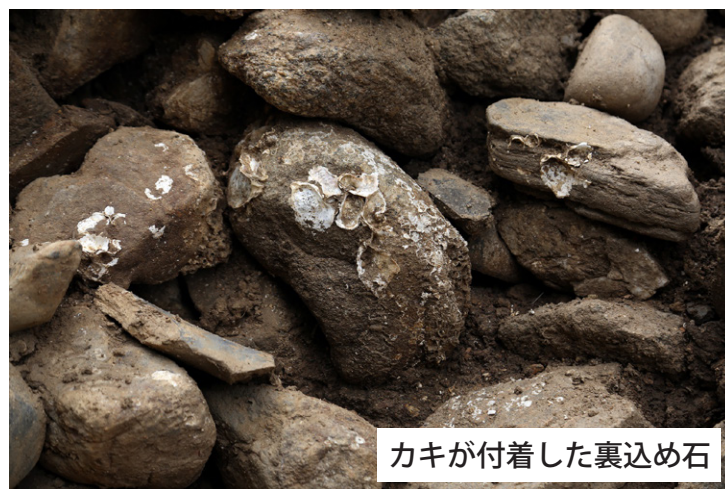
フジツボが付着した裏込め石
