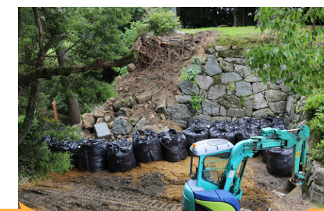
⑨応急復旧作業の様子 安全確保のため、周囲を大型土嚢で囲いました。
